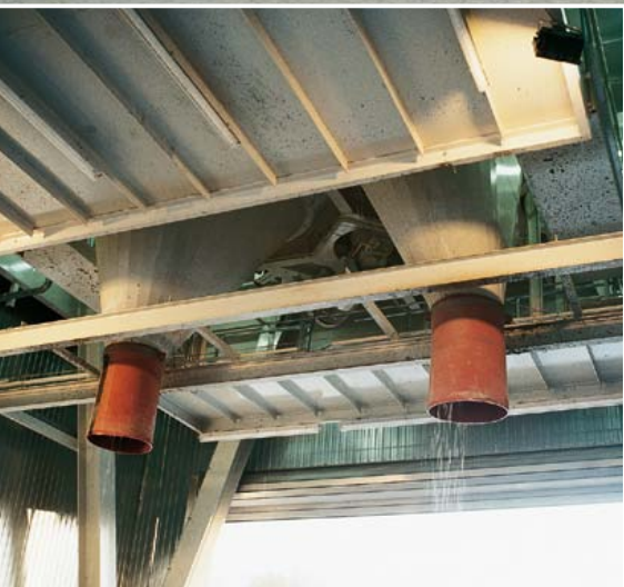
Bocas de descarga de amasadora
