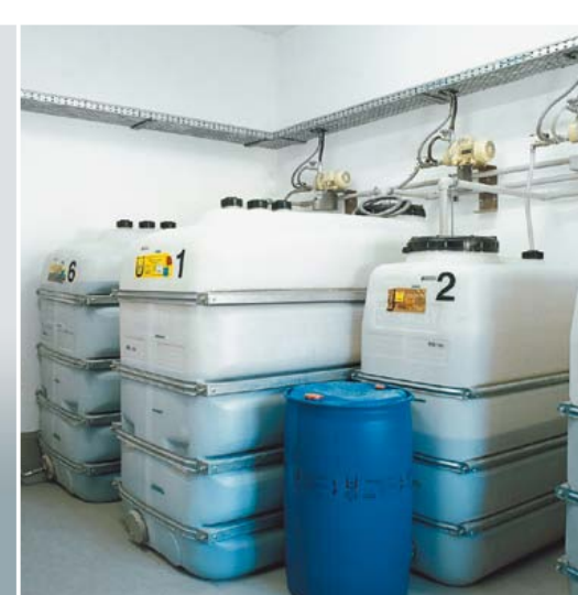
Contenedores de aditivos
