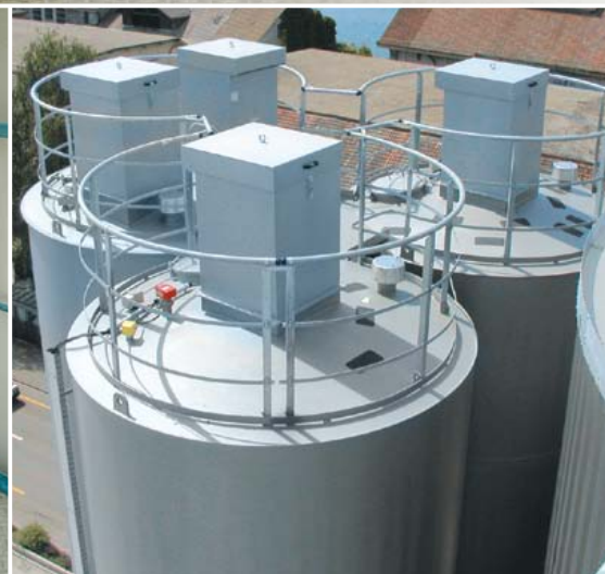
Filtros de silo de cemento
