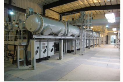
GIS 362 kV/63 kA
